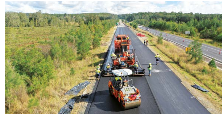
AUSTRALIË – Een team van Colas Australia brengt op een weg van Clybucca, in New South Wales een laag SMA10-asfalt aan.
