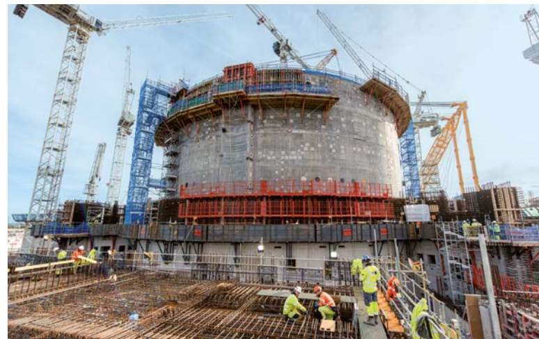
英国 - 隶属Baylor合资集团的布依格公共工程公司正在为位于Hinkley海岬的核电站之反应炉进行土木工程。
