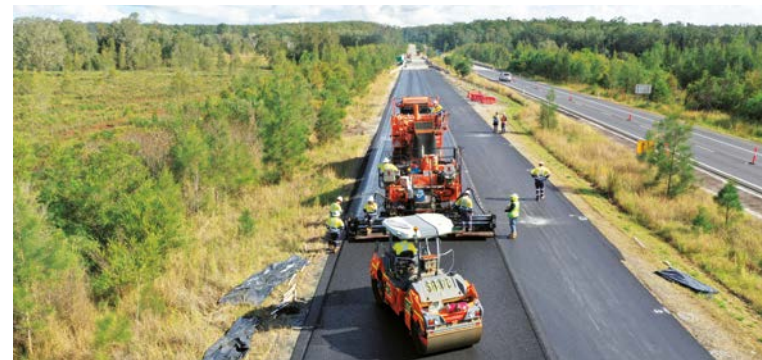
AUSTRALIEN - Ein Team von Colas Australia bringt Asphalt mit der Klassifizierung SMA10 auf einer Strasse in Clybucca, New South Wales, auf.
