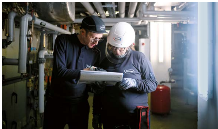
FRANKREICH – Electra, eine Initiative von Bouygues Energies & Services, ist die erste Schulung, die sich ausschliesslich an Frauen richtet, die sich für den Beruf der Elektrikerin umschulen lassen. Hier sieht man Morgane Prime neben ihrem Tutor Idir Sidhoum.
