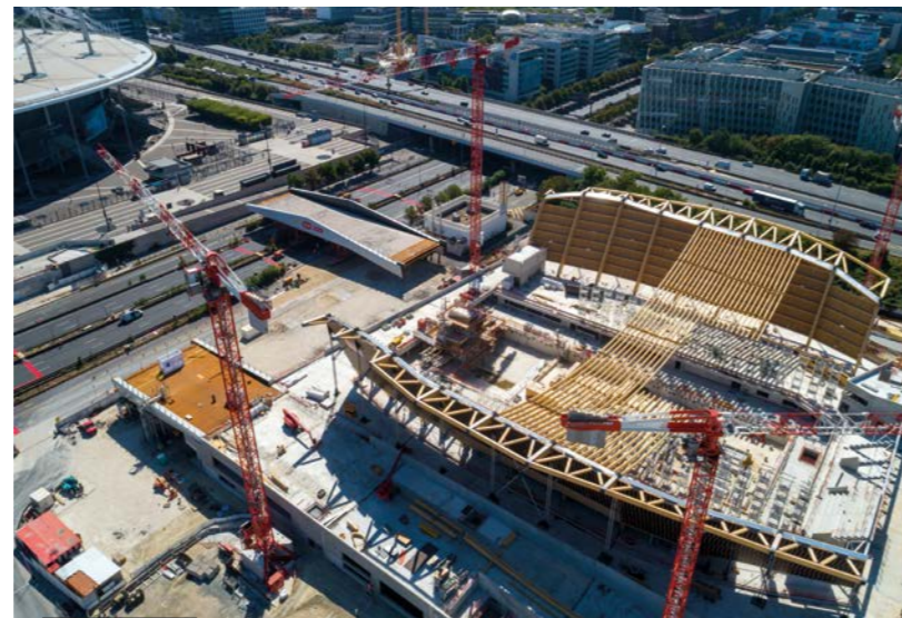
FRANKREICH – Bau des Olympischen Wassersportzentrums (Centre Aquatique Olympique – (CAO)) unter der Federführung von Bouygues Construction in Saint-Denis – eine für die kommenden Olympischen Spiele in Paris (2024) wichtige Anlage.
