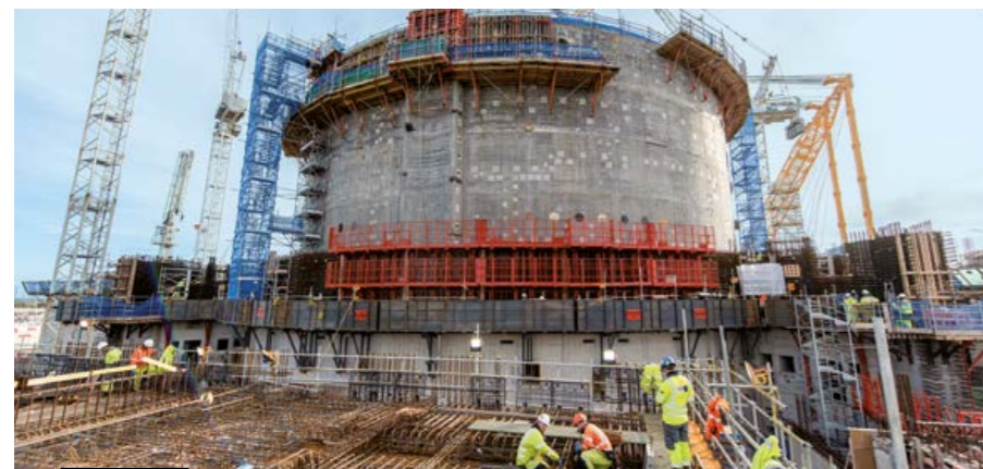
ROYAUME-UNI - Bouygues Travaux Publics, au sein du groupement Bylor, réalise le génie civil des deux réacteurs EPR de la future centrale nucléaire d'Hinkley Point.
