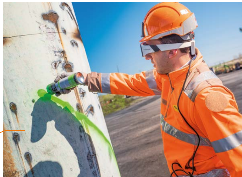
位在Ambès (法国新阿基坦地区) 工厂的拆除工作。有拜他头上所戴的扩增实境安全帽之赠，这位工作人员得以实时看到他正在进行的细膩工作之显示情况，让他避免误解工地施工计划书，同时亦增加自己的安全。
