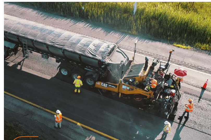
Die Anwendung von Techniken der Kreislaufwirtschaft bei einem Projekt zur Erneuerung des Straßenbelags auf der Interstate 81, die durch North Syracuse (Bundesstaat New York) führt. Diese ermöglichen die sofortige Wiederverwendung von aufgearbeitetem Fräsgut in der neuen Asphaltmischung. Weiterer Vorteil: 35 000 Tonnen des aufgearbeiteten Fräsguts wurden auf anderen Baustellen in der Region verwendet. Der vom Kunden erwartete Recyclinganteil wurde übertroffen.
