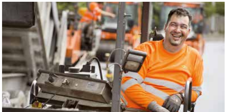
Auf der Baustelle der A22 in Nordfrankreich, Mohamed Boudemdani von Colas Nord-Picardie
