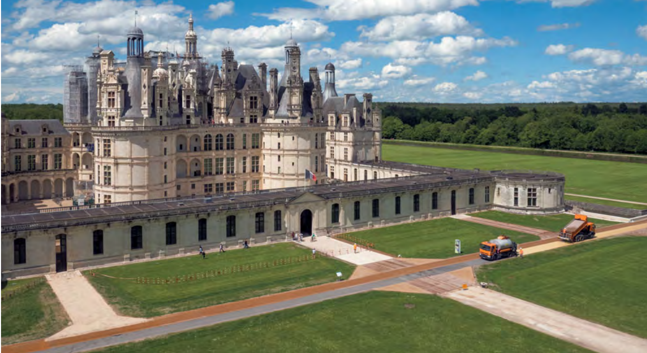
Als Mäzen stellte Colas seine Kompetenzen in den Dienst von Chambord: Rund um das Schloss wurden 6 000 m 2 Wege erneuert.
