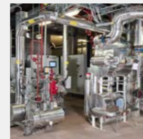
Système de refroidissement écologique et pompe à chaleur haute température à la laiterie Ennstal en Autriche par Equans
