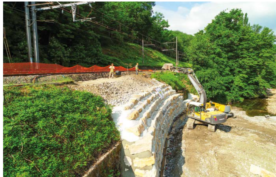
FRANCIA - Obras hidráulicas y ecológicas: orilla con pendiente muy suave aguas arriba, zona de expansión de crecidas y espacios naturales para no afectar a los castores que viven aguas abajo, confluencia con el río Couzon para dar un mayor espacio de divagación al Gier.
