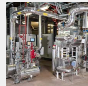
Sistema de refrigeración ecológico y bomba de calor de alta temperatura en la central lechera de Ennstal (Austria) fabricado por Equans
