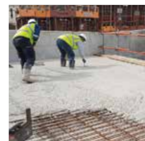
Béton bas carbone chez Bouygues Construction
