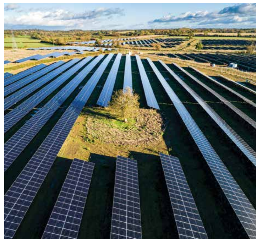
ROYAUME-UNI - La ferme solaire Fox Covert dans le comté de Buckinghamshire permettra d'alimenter 7 500 foyers en électricité et d'éviter l'émission de 4 942 tonnes équivalent CO 2 par an.
