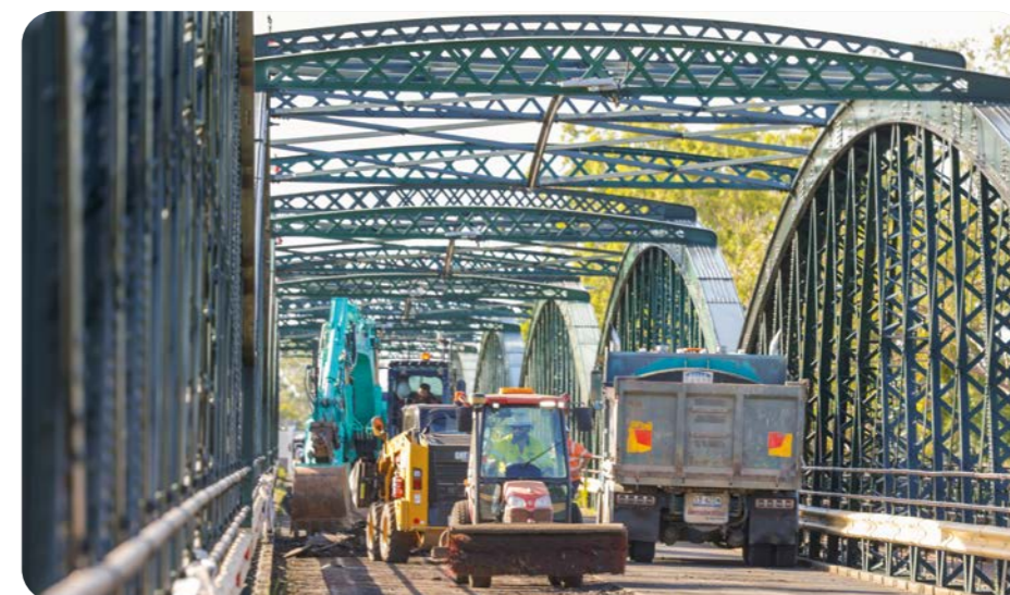
AUSTRALIE - À Bundaberg, dans le Queensland, Colas Australia a renoué le Burnett river bridge, un pont vieux de 120 ans. Grâce à une organisation millimétrée - travaux de jour et de nuit, fermetures planifiées et sécurité renforcée - l'ouvrage a retrouvé toute sa fonctionnalité.
