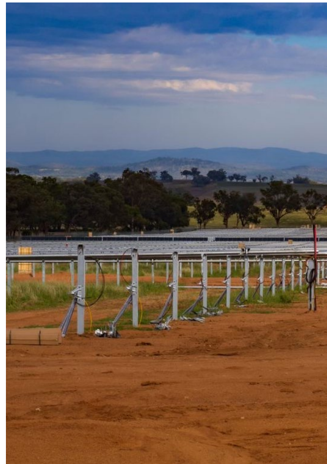
Bouygues Energies & Services - Ferme solaire Suntop Australie
