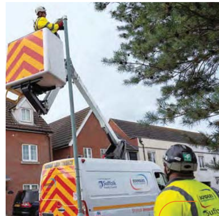
Le nouvel éclairage public du comté de Suffolk en Angleterre réduira les coûts d'au moins 60 % tout en économisant de l'énergie et en diminuant la pollution lumineuse.
