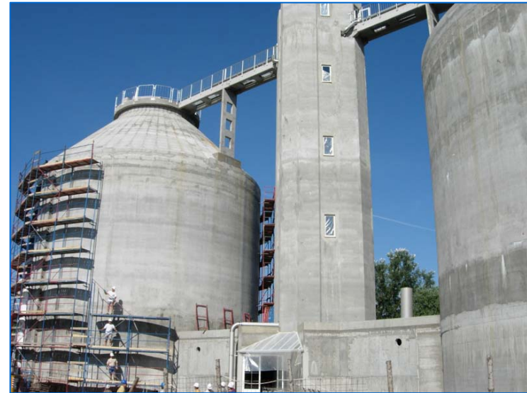
Station d'épuration ALTERRA, Hongrie
